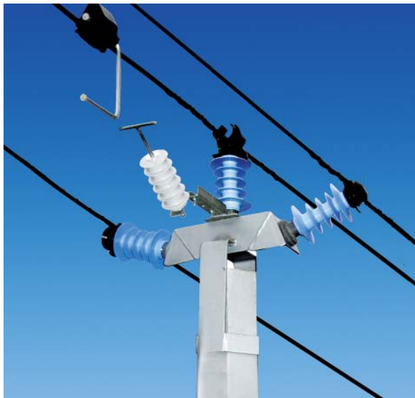
Рис. 1. Траверсы с полимерными изоляторами ОЛСК (ТВИ)
