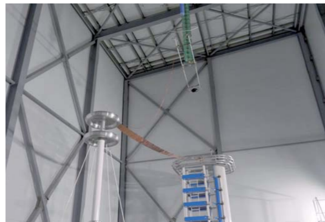
Зал для высоковольтных испытаний ИЦ АО «ЮМЭК»
