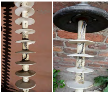
Рис. 6. Эрозия и трек на внешней поверхности защитной оболочки изоляторов I поколения
